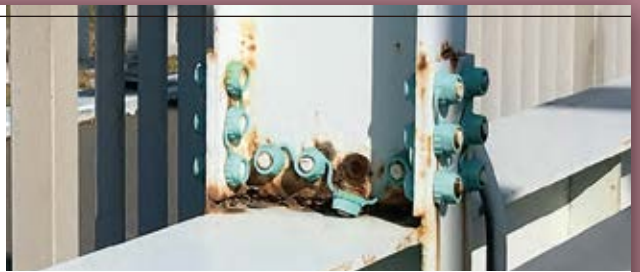
市民の方から新橋のボルトに異変があると連絡を頂き、異変があるボルトを探しに。時間がかかりましたが無事発見。調査の結果10個のボルトが抜けていたことが判明しました。修復され今は耐震工事に取り掛かっているとのことでしたが、適切な管理をしていただき、腐食等防ぐために塗装も含め管理を土木建築委員会に要望いたしました。
