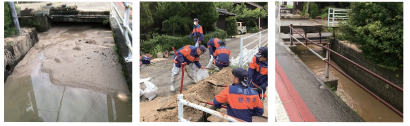
6月30日～7月1日の警報級の豪雨で天神山から土砂が水路沿いに迫戸川に流出。橋桁に迫る勢いの為、地元消防団の有志と人力で撤去作業。その後重機など市から投入して頂きいつもの流れに戻りました。私、松浦多紋はどこにいるのでしょうか？
