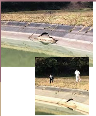
選挙区外のため池ですが、のり面に巨大な穴が開いていましたので、先ずは調査を依頼。梅雨時期ではなく良かったです。
