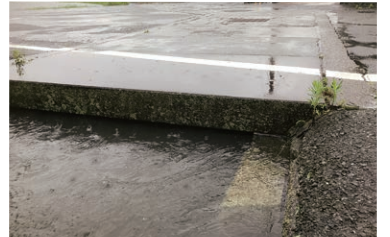
越水寸前の用水路。内水氾濫の原因ともなる状況を打開するための提言を11月議会で発言し、質問。
