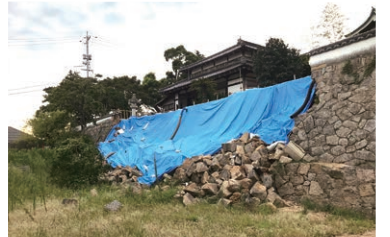
山口県指定の記念物である防府天満宮大専坊跡で石垣と土塀が崩壊。早急な予算確保を11月議会で要望。
