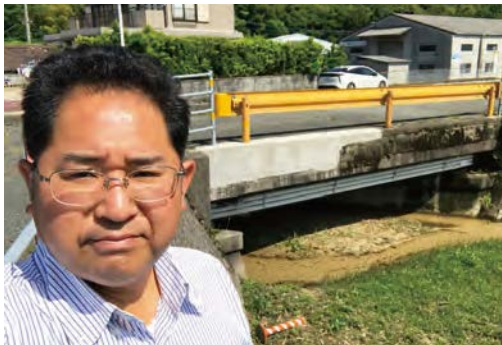
現地まで赴きました。「なるほど、橋の下には土砂が堆積しています!」
