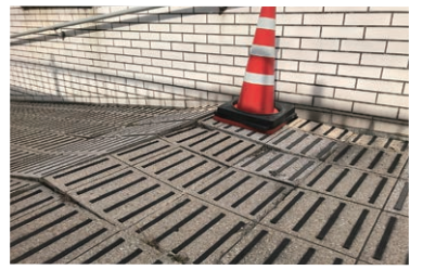
大道・観音口の地下道のタイルが隆起しています！歩行者・自転車などの通行の安全確保に対応。
